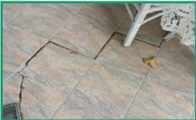
Kein stabiler Untergrund - Risse sind die Folge
