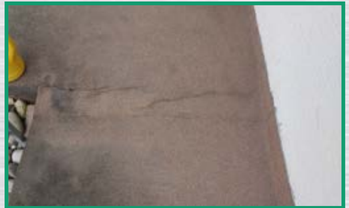
Risse im Steinteppich
