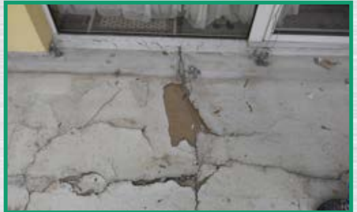
Flüssigbeschichtung blättert ab
