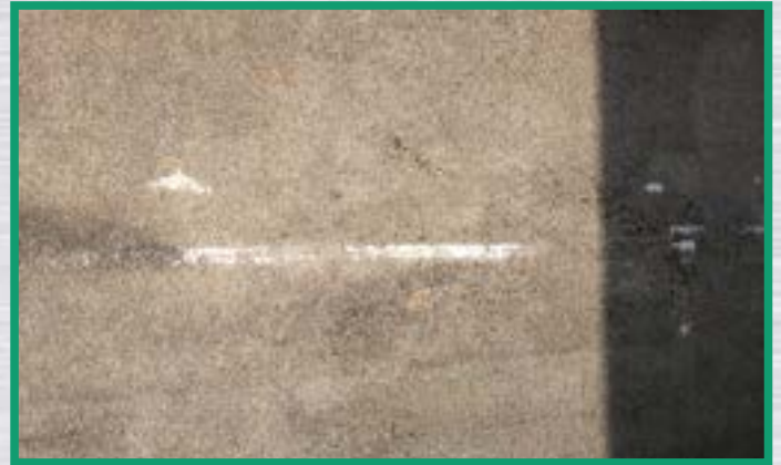
Steinteppich verliert Steine - hier 80 m 2
